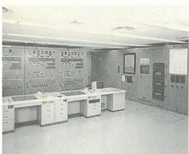
制御室ではコンピュータによって変電所全体を24時間監視制御している
