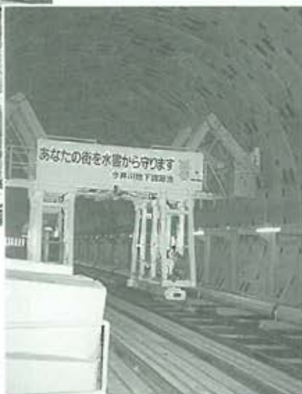
▶トンネルの内部はセグメントというブロックが隙間なく張りつけられていく
