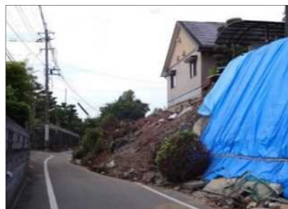
《H28 熊本地震での小規模擁壁被害》
