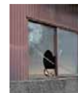
窓が割れた 管理不全空家
